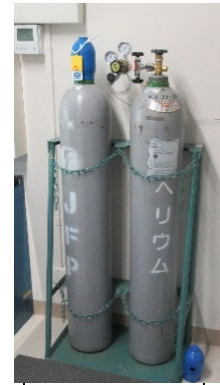
ガスボンベ ボンベ架台
